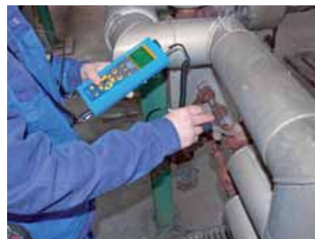
Kontrola odlučovačů vody
