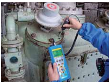
Kontrola ventilů kompresoru
